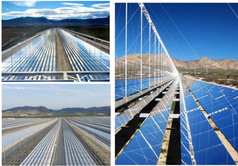
Figura 14 – Campos solares lineares de Fresnel de Novatec nas estações de energia PE1 (Nova1) e PE2 (SuperNova) na Espanha
