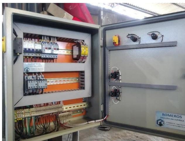
Figura 14 - Quadro elétrico de comando
