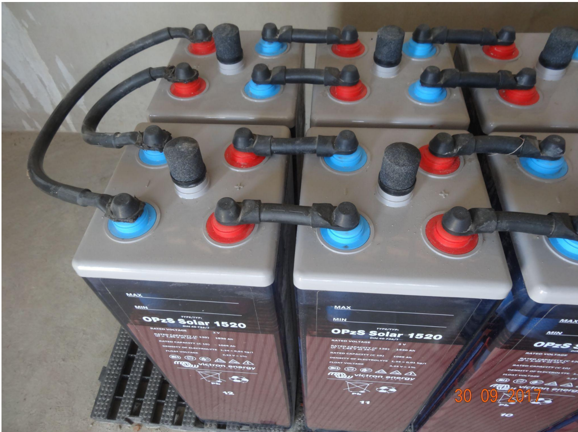
Figura 5 - Banco de baterias
