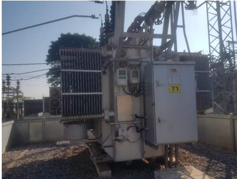
Figura 27 – Transformador de potência T1 da subestação de Formiga.
