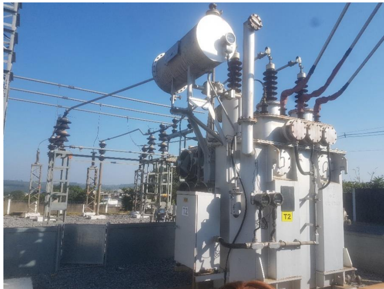
Figura 28 – Transformador de potência T2 da subestação de Formiga.
