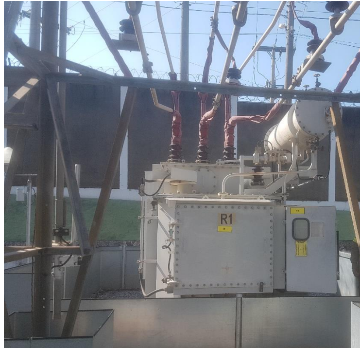
Figura 29 – Regulador de tensão trifásico conectado em barramento principal.
