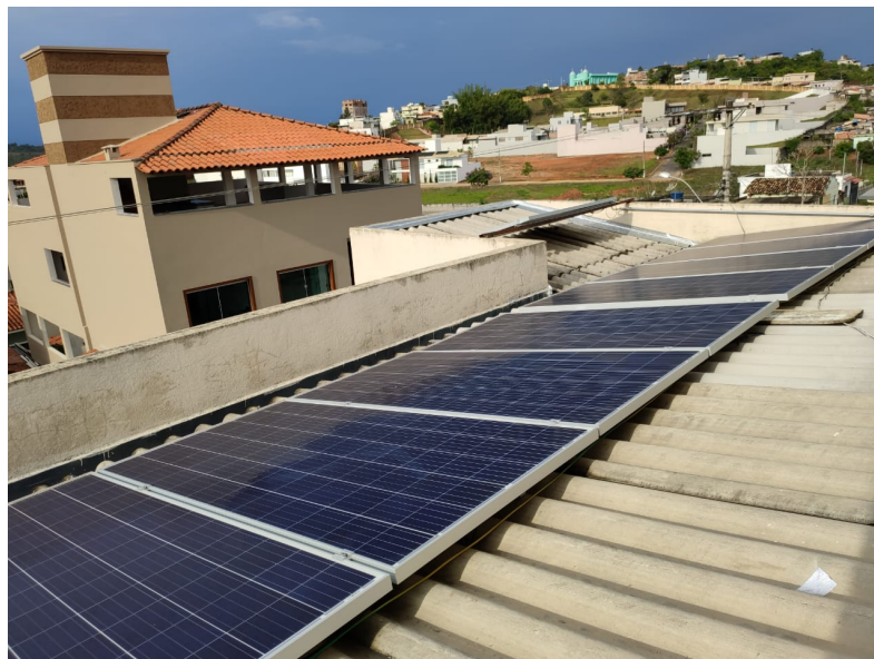
Figura 25 – Sistema FV residencial 1 instalado na cidade de Formiga-MG.
