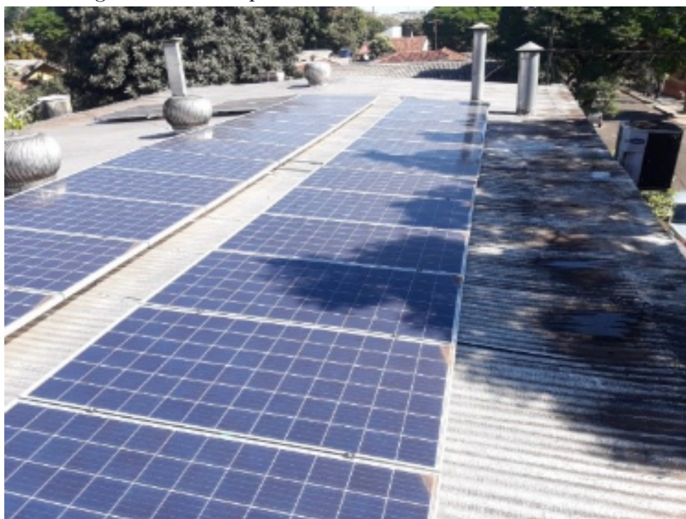
Figura 12 – Exemplo de sombreamento em sistemas FV.
