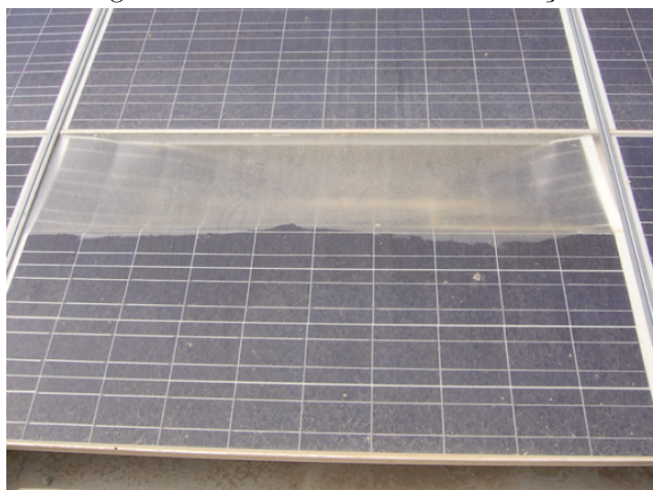
Figura 9 – Módulo FV com delaminação
