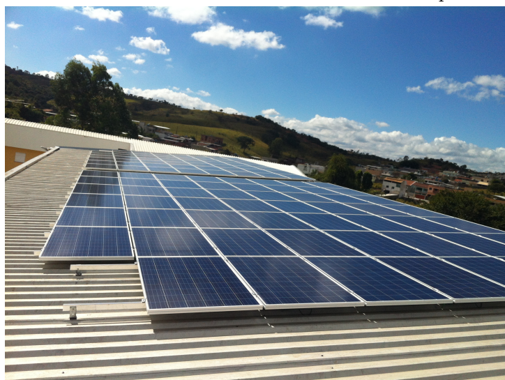
Figura 21 – Sistema FV instalado no IFMG - Campus Formiga.
