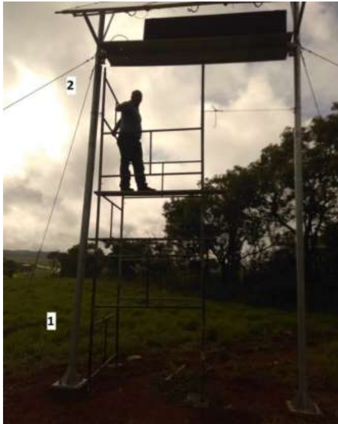
Figura 31 - Foto da instalação com enfoque na estrutura do SFI.
