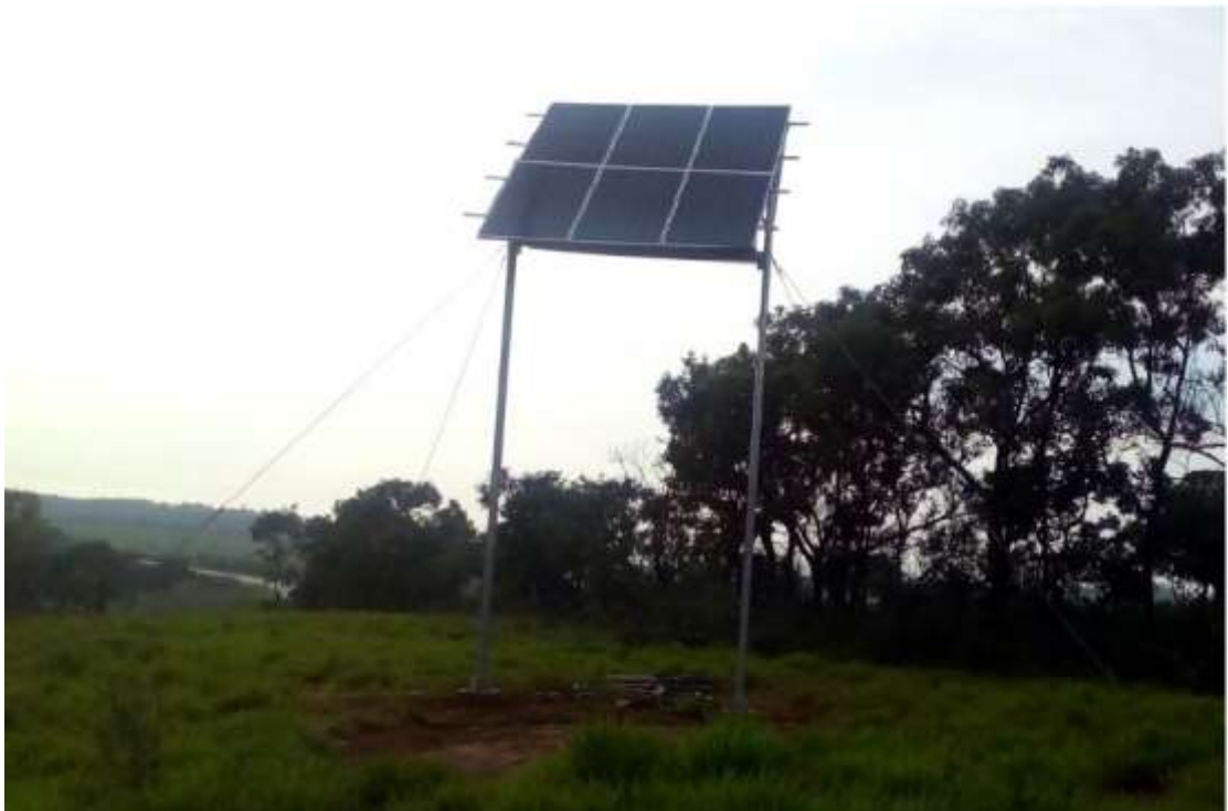
Figura 30 - Vista frontal do SFI instalado.
