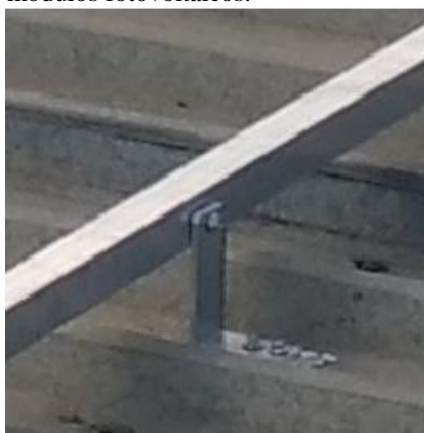
Figura 10 – Estrutura de fixação para os módulos fotovoltaicos.
