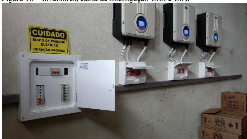
Figura 16 – Inversores, caixa de interligação C.C. e C.A.
