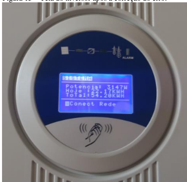
Figura 15 – Tela do inversor após a correção do erro.
