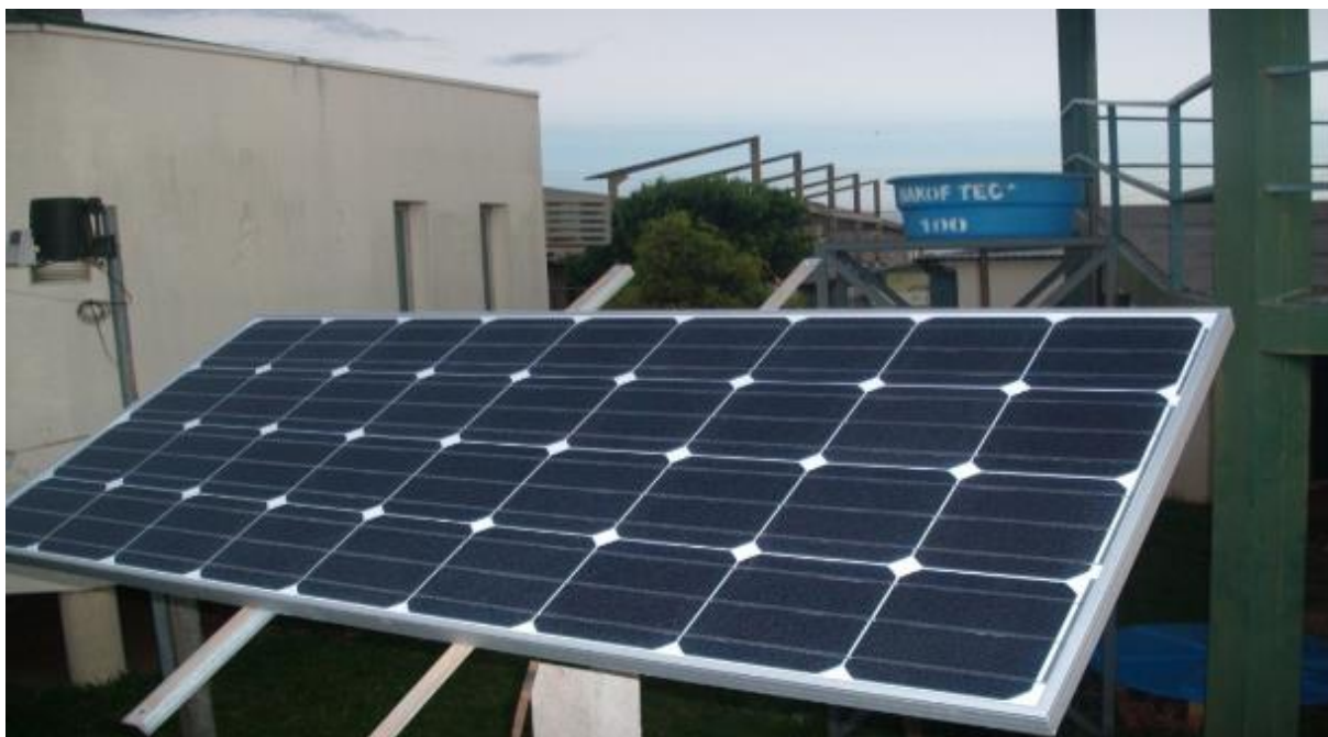
Figura 12 – Visão geral do módulo fotovoltaico monocristalino instalado.
