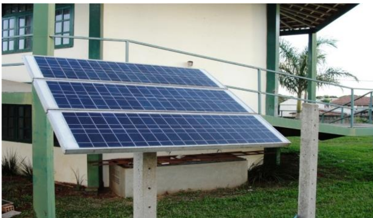
Figura 11 – Visão geral do módulo fotovoltaico policristalino instalado.
